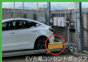
EV 用充電器つき立体駐車装置
