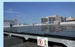
横浜事業所に設置された太陽光パネル
