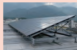
駒ヶ根工場に設置された 太陽光パネル
