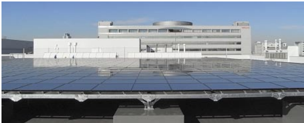
太陽光発電設備
