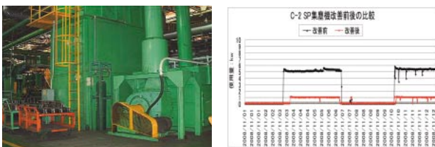
集塵機のインバータ化
