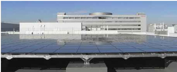
研究開発棟の屋上に設置された太陽光発電設備
